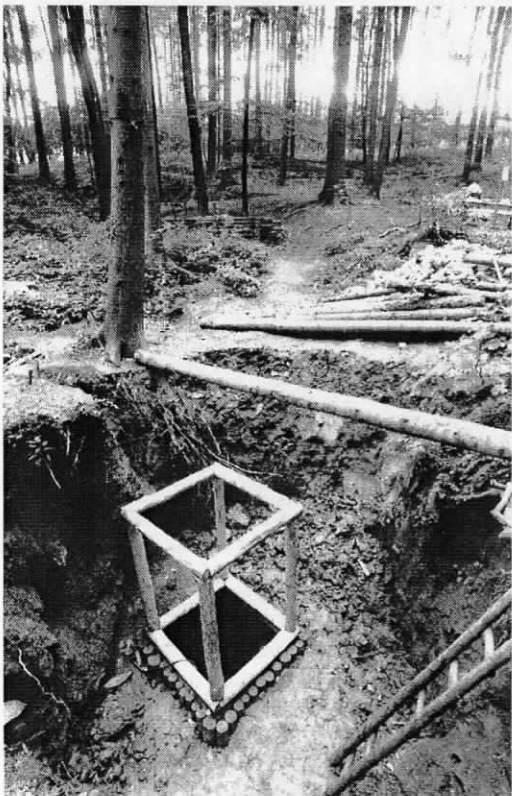
Foto: Způsob výstavby výdřevy do Ponorného hrádku za současného zasypávání průzkumné sondy v Novodvorském ponoru (1992-1993)
